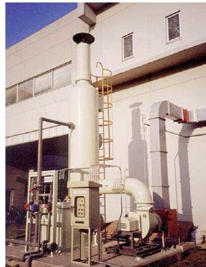
研磨工場 (煤塵処理)
