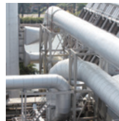
ダクトワーク Duct work
