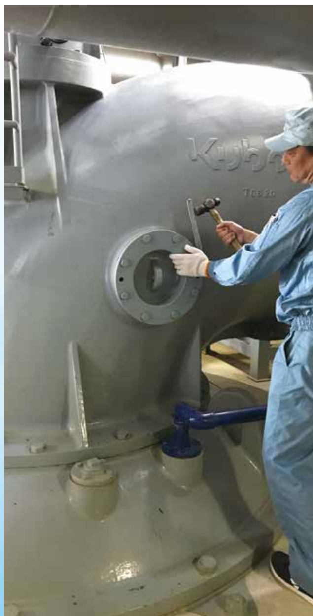
既存ポンプ設備点検窓
