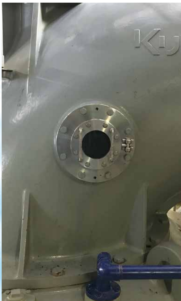
内部診断用窓
